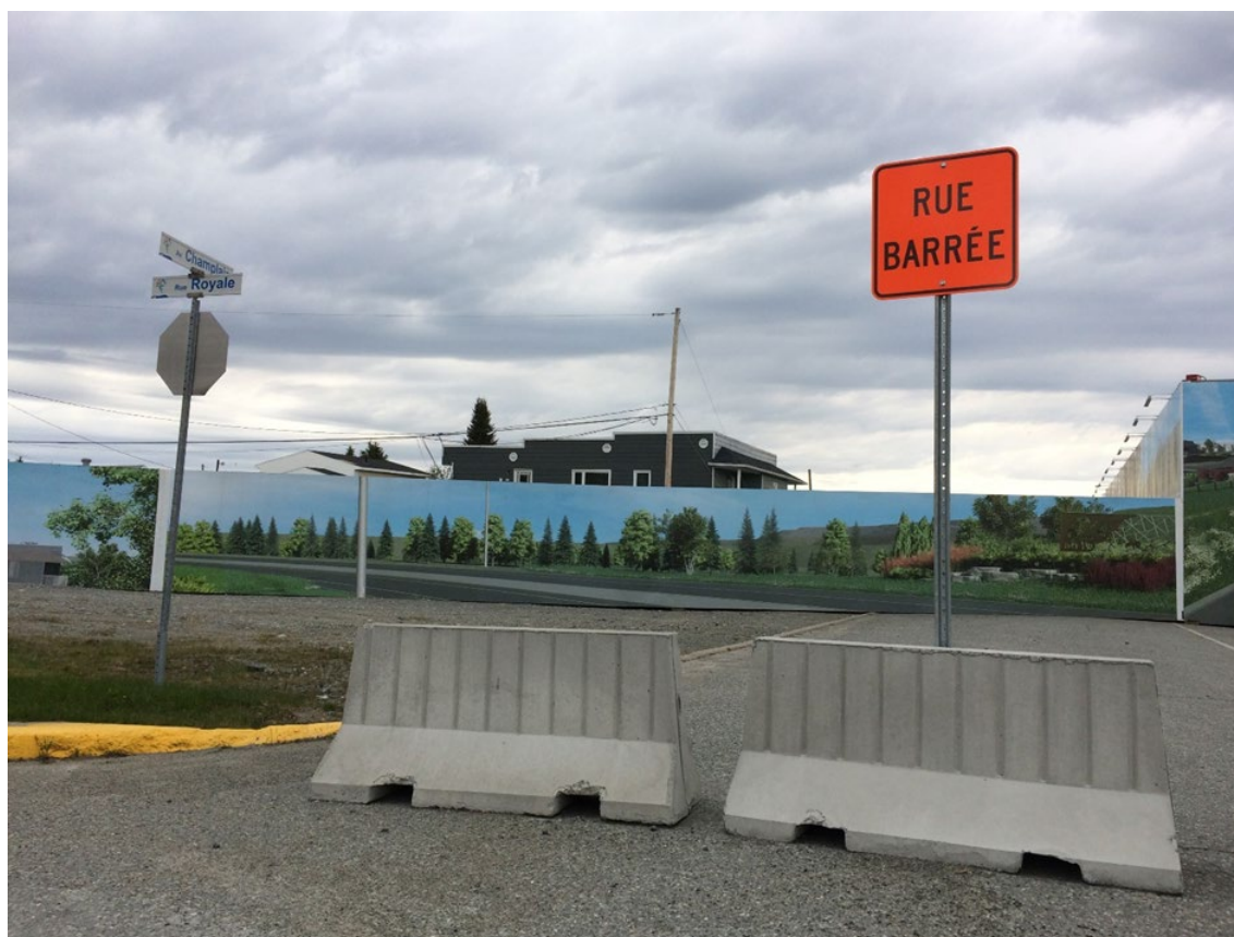
Figure 6 : Panneaux érigés durant les travaux de construction de la voie de déviation de la route 117
